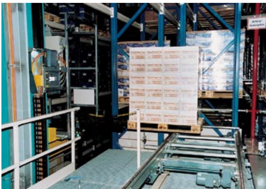
Automatische Fördertechnik des Hochregallagers
